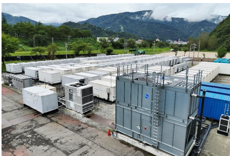
ゲットワークスが新潟県湯沢町に設置したコンテナデータセンター
